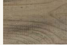
Umweltkeime, Stockflecken und leichter Schimmelbefall
