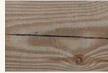
Spannungsrisse durch die Holz Trocknung
