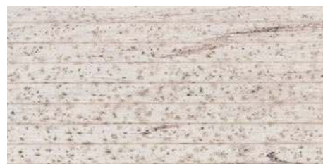
Stockflecken/Schimmel auf der Oberfläche
