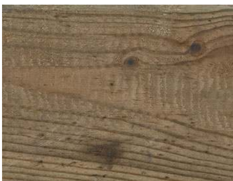
Raue Stellen auf der Holzoberfläche
