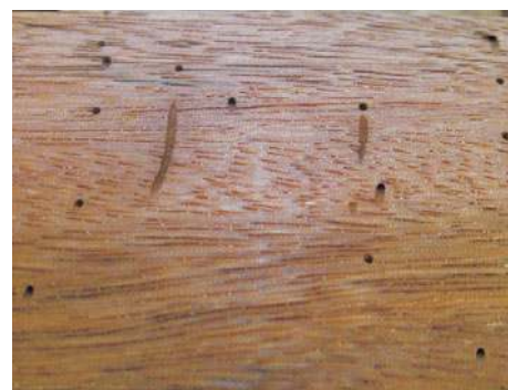
„Pinholes“ bei überseeischen Harthölzern
