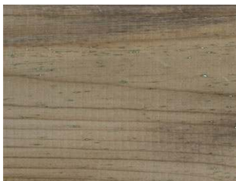
Umweltkeime, Stockflecken und leichter Schimmelbefall
